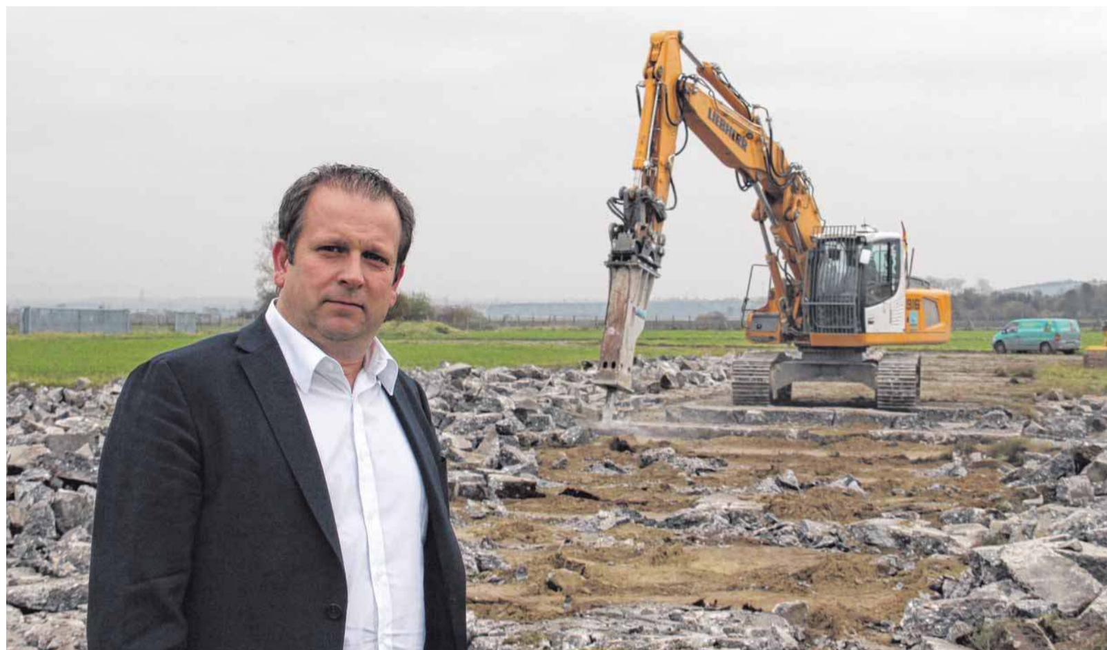
Ehoch4-Projektleiter Jürgen Gaugel schaut auf dem ehemaligen Kasernengelände nach, wie weit der Rückbau vorangeschritten ist.
